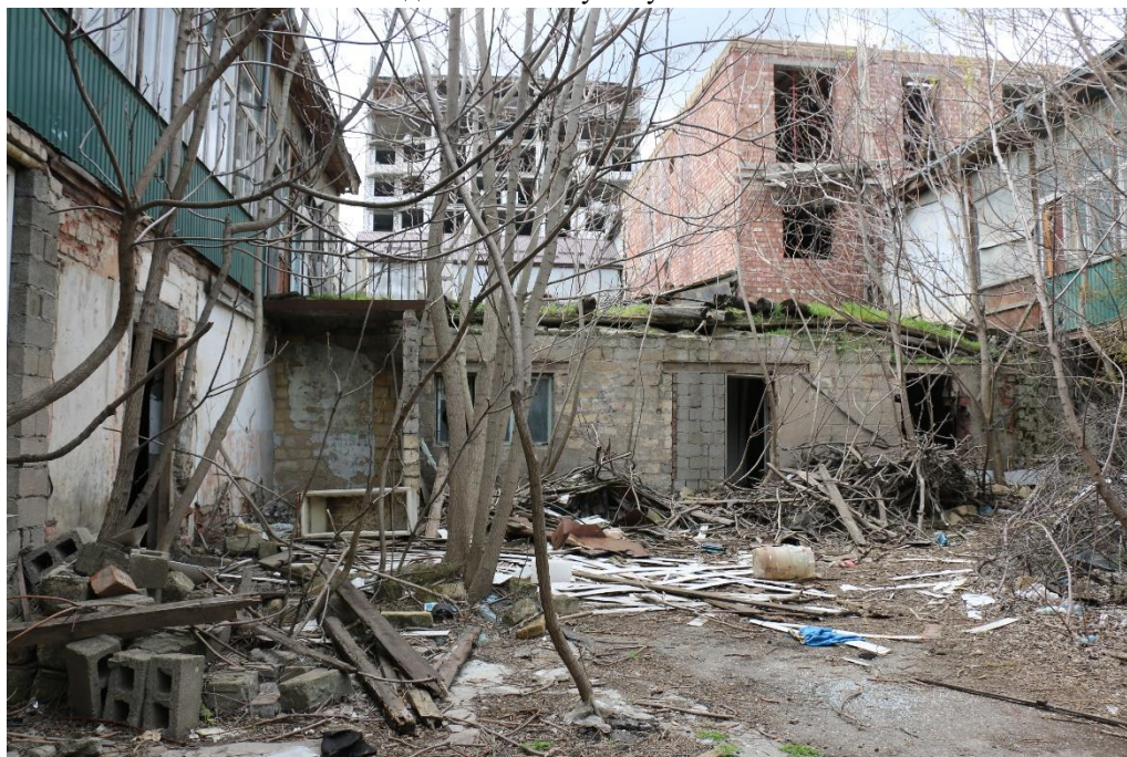
Руинированная часть двухэтажной пристройки, примыкающей к дворовому фасаду здания № 6 по ул. Пушкина.
