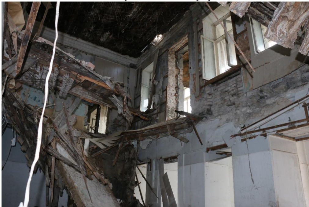
Аварийное состояние перекрытий
