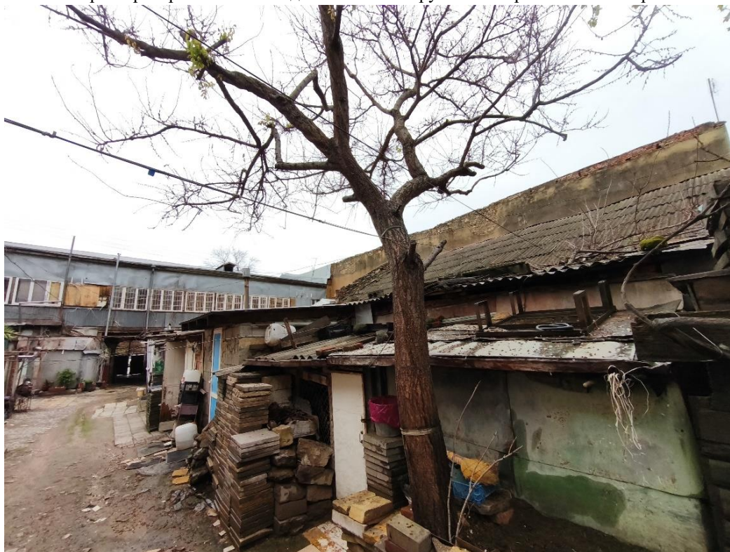
Вид на позднюю двухэтажную пристройку дворового фасада здания 4 по ул. Пушкина к которой пристроены ветхие одноэтажные сооружения из различных материалов
