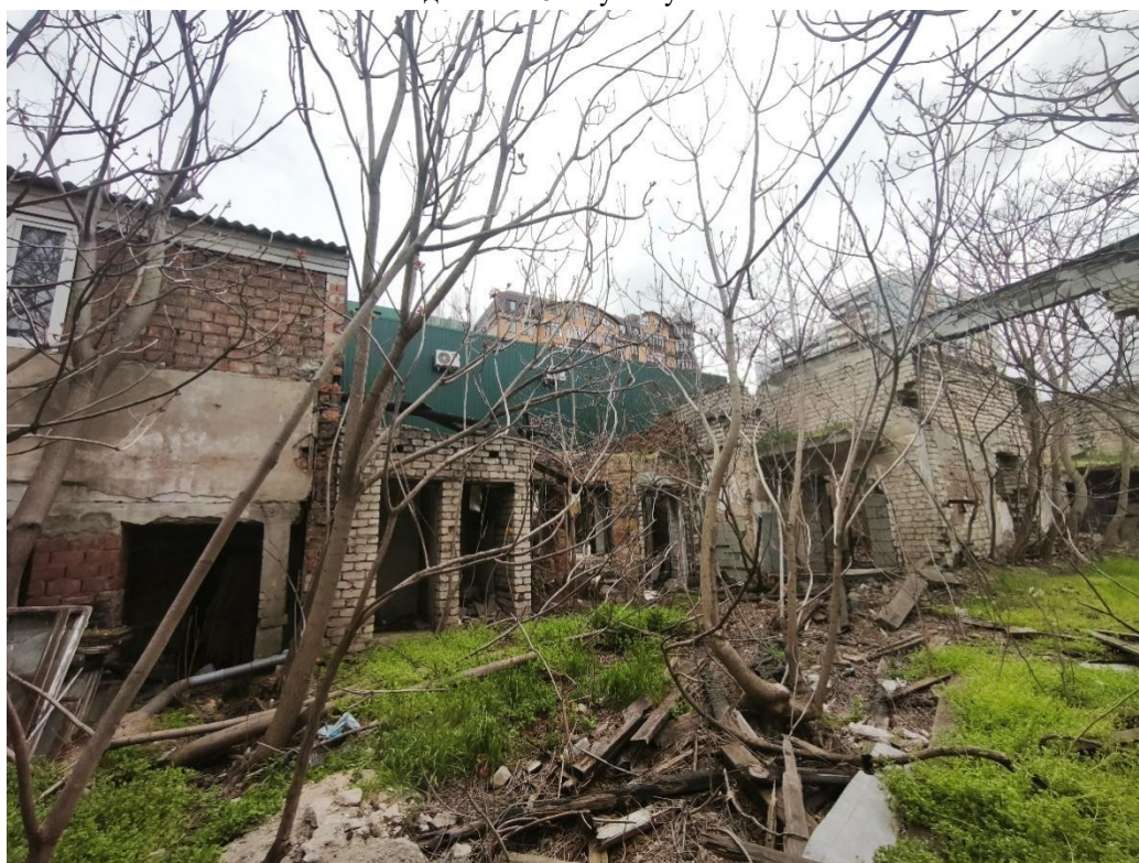
Руинированная часть двухэтажной пристройки, примыкающей к дворовому фасаду здания № 8 по ул. Пушкина.
